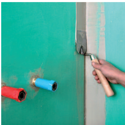
Vor dem Ausführen der Details (Wand- und Wand- Bodenanschlüsse) ausreichend viel Abdichtungsmaterial vorgelegt.
